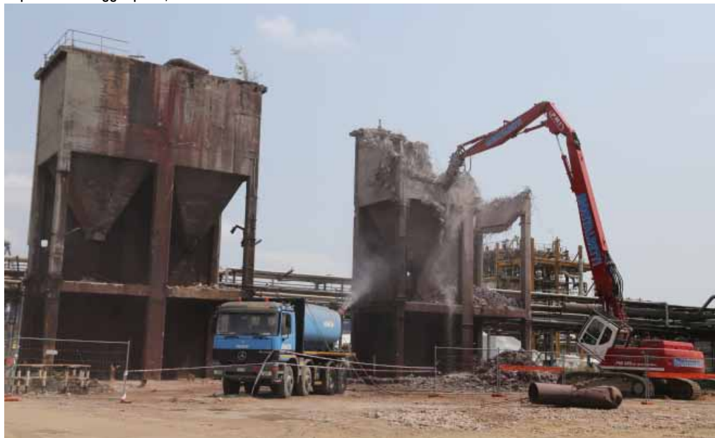
Impianto stoccaggio pirite, forni 1 e 2
