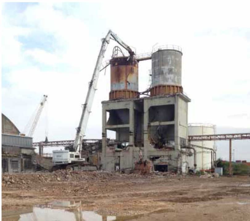
Impianto AS 12 (zona insacco)
