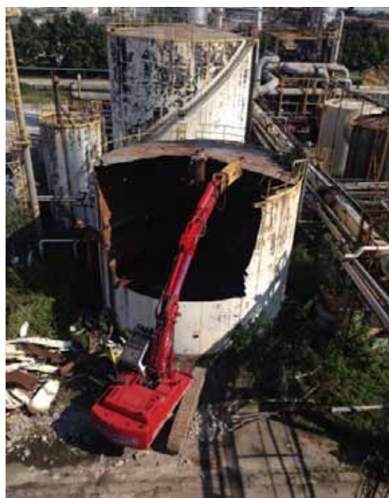
Impianto stoccaggio serbatoi
